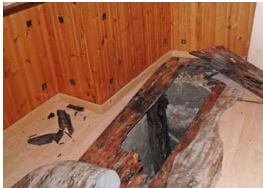
Die eingestürzte Decke
