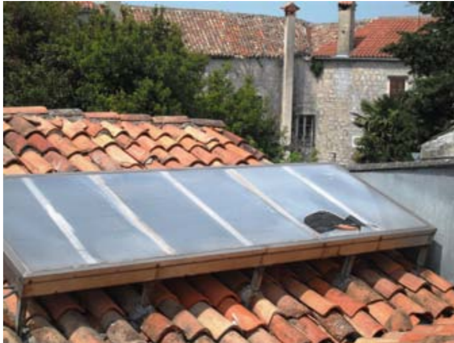
Sturmschaden an der Solaranlage
